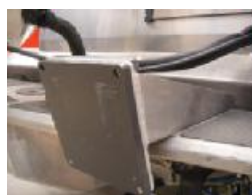
Support moteur secours
